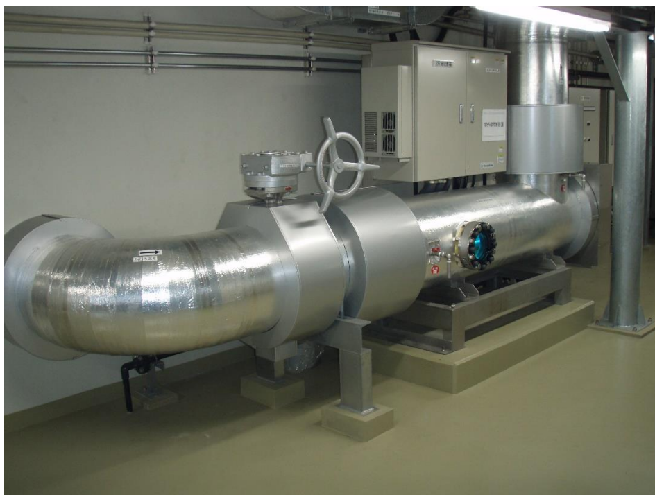
紫外線照射装置（石川浄水場内）
