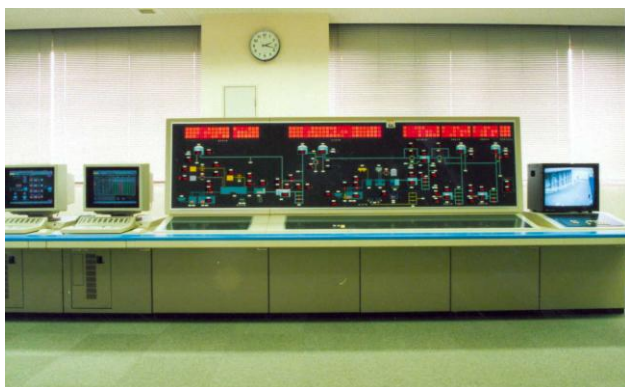
〔中央監視設備〕
