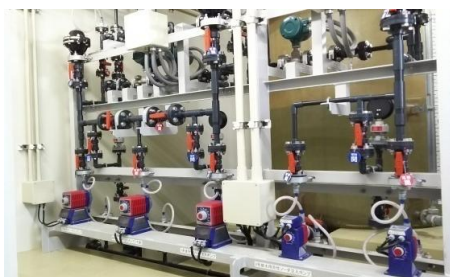
苛性ソーダ自動注入設備 (石川浄水場内)
