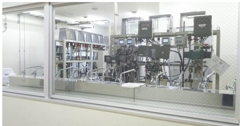
連続水質測定計器 石川浄水場
