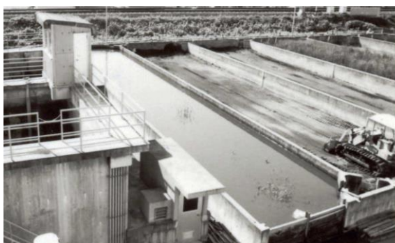
〔石川浄水場汚泥処理設備〕
