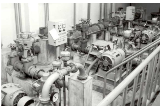
〔石川浄水場送水ポンプ設備〕
