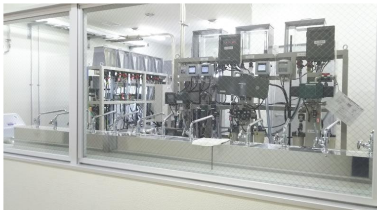
連続水質測定計器 石川浄水場
