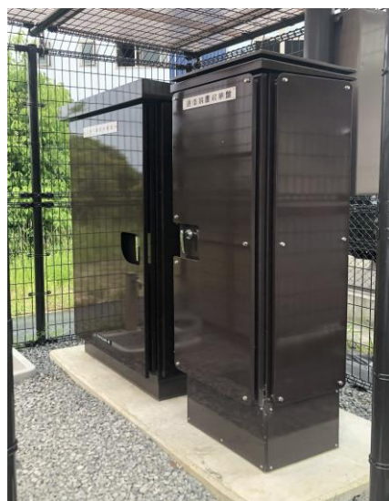
〔壺井系配水モニタ〕
