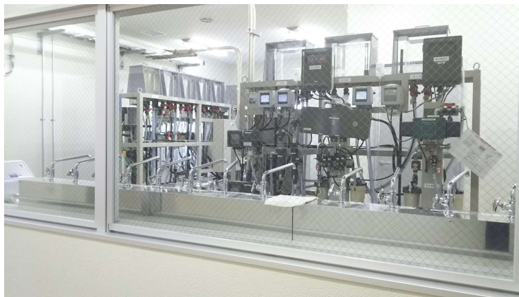
連続水質測定計器 石川浄水場
